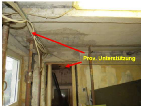
Bild 2 Setzungsschäden, provisorische Abstützmaßnahmen unterhalb Geschossdecke und Türsturz Schadensstelle: Raum unter der Bühne
